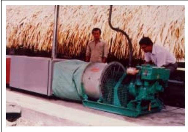
Figura 24-5. Sistema de calentamiento a base de gas propano, acoplado a un secador de capa fija.
