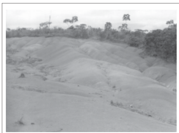
Figura 6-4. Daño severo de erosión en la región de Mondomar, Cauca, Colombia.
